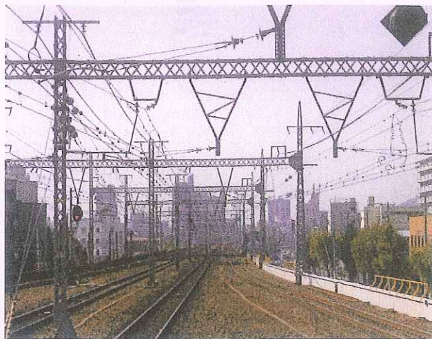
▲JR西日本電車線支持物
