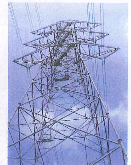
▲東京電力(株)下館支社管内 送電鉄塔
