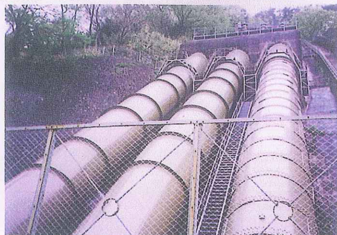
▲中部電力（株）大井川発電所 水圧鉄管
